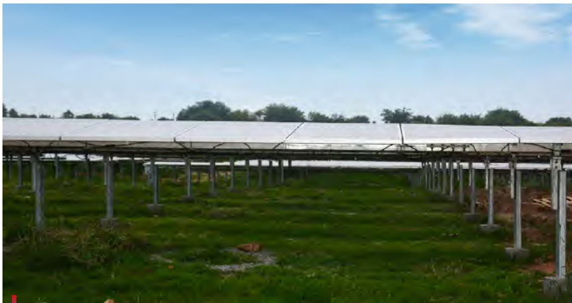
Solar Plant, JSW Neo
